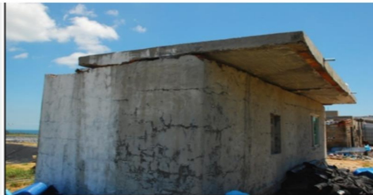
文昌翁田镇岸边被“威马逊”移位的屋顶
