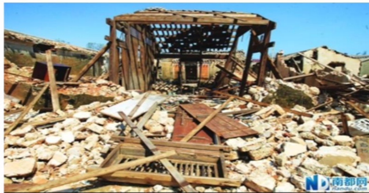
文昌翁田镇下村被“威马逊”摧毁的房屋
